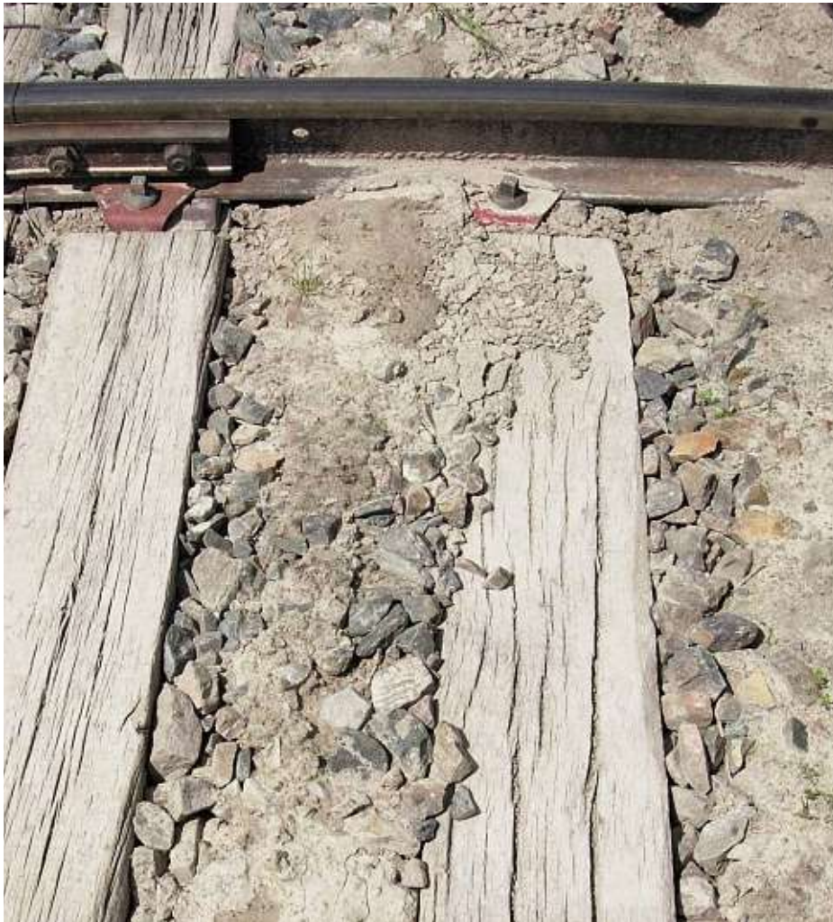
Durch aufstossendes Wasser verschlammter Schotter, das Schotterbett kann die Federfunktion nicht mehr wahrnehmen.
